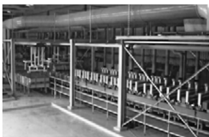
Рис. 10. Линия для нанесения гальванических покрытий
