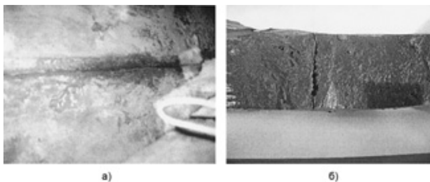
Рис. 6. Трещины в монтажном шве листов днища (а) и перекрестиях швов днища (б)
