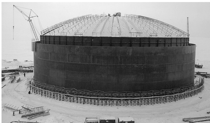
Рис. 1. Общий вид двухкорпусного вертикального цилиндрического резервуара вместимостью 50 000 м 3 со стационарной стальной крышей основного корпуса
